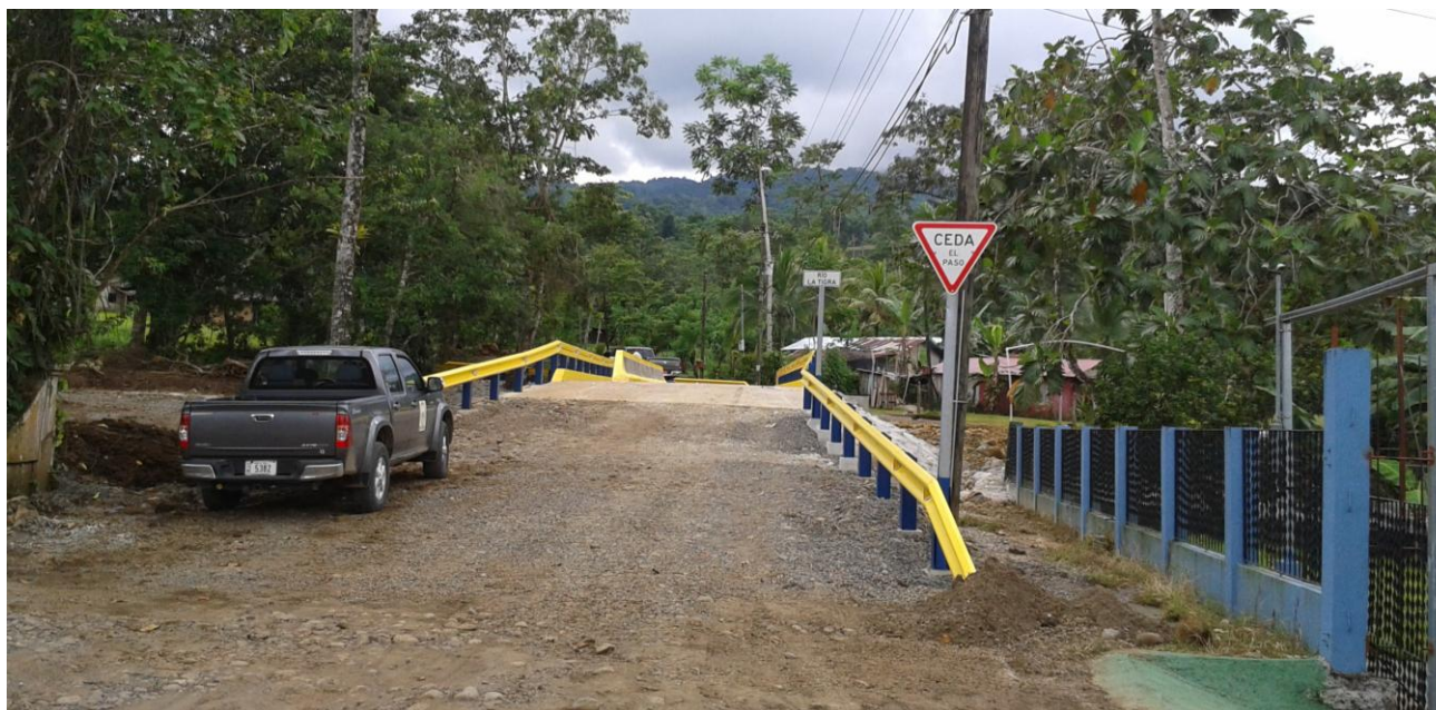
Vista del Acceso derecho del puente junto con el señalamiento Vertical.
