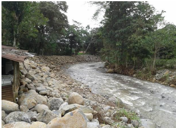
Material apilado a lo largo de la margen izquierda, protección de viviendas
