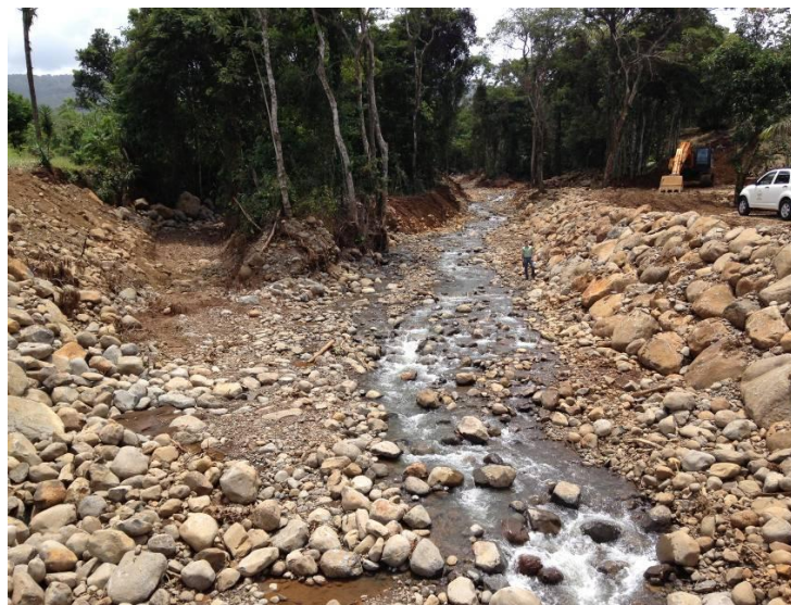
Sitio aguas arriba inmediato al puente sobre Ruta Nacional N°702, observándose el gran mejoramiento de la sección del cauce del río Esteller, para evitar desbordamientos
