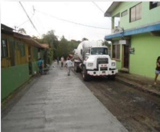
Carpeta Asfáltica, Calle El Milagro, Ciudad Quesada, 2-10-153
