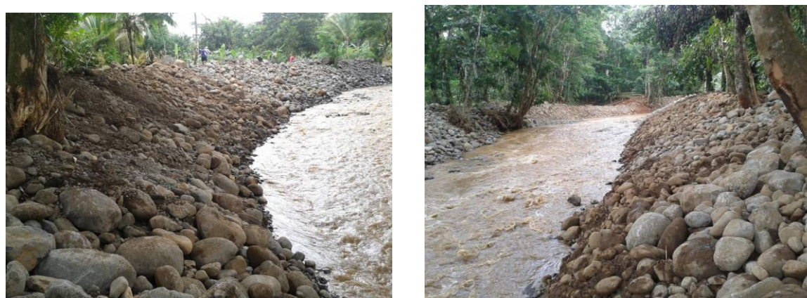
Conformación de dique utilizando el propio material existente en el cauce río La Tigra, siendo este un sitio donde ocurrió desbordamiento hasta alcanzar el camino.
